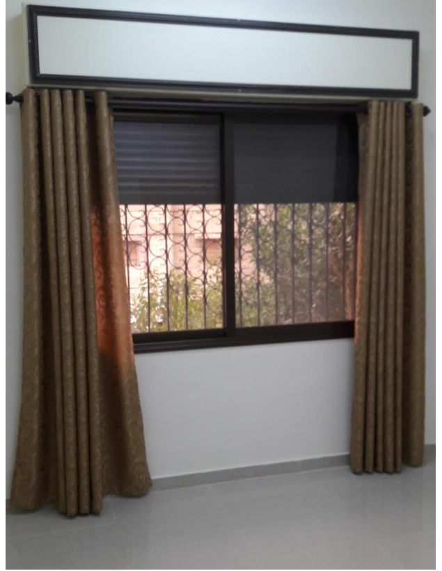
تنفيذ أعمال إكساء (مشروع إعادة تأهيل مركز منين الصحي) لصالح منظمة ميدير
