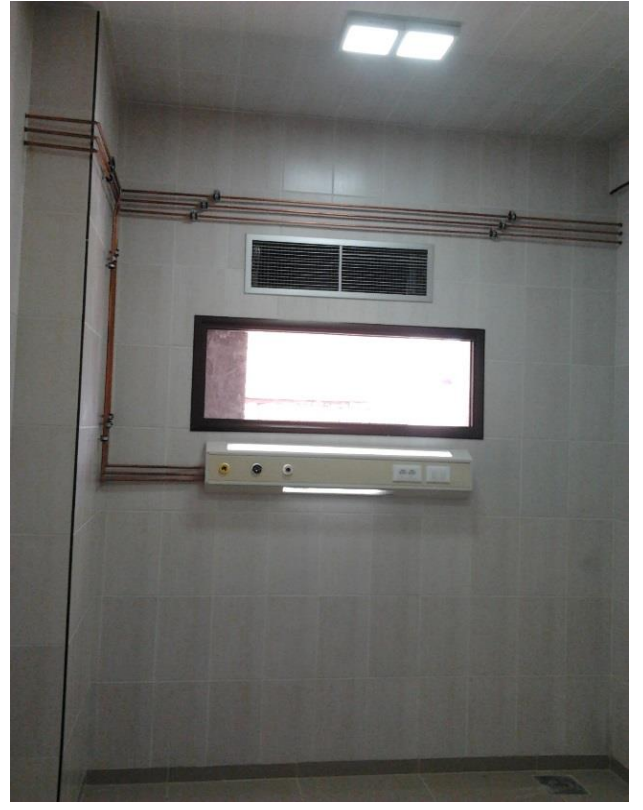
تنفيذ شبكة غازات طبية ووحدات رأس المريض لغرف العزل (تجديد الأقسام النفسية والحمجية في مشفى المواساة بدمشق) لصالح منظمة الصحة العالمية
